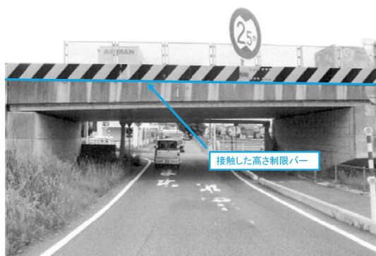
写真 3 事例 4 事故状況写真
