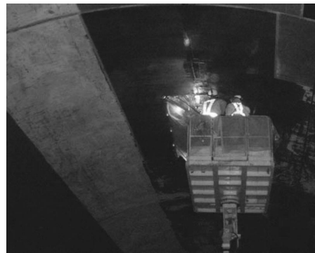
写真 2 事例 2 事故状況写真
