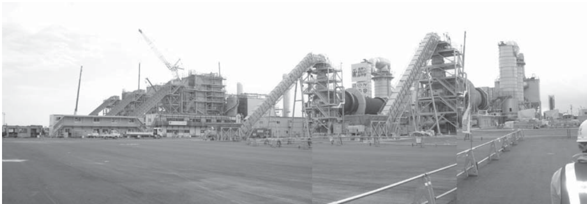
写真—1 石巻ブロック二次仮置き場状況（仮設焼却炉300t/日×5基を望む）
