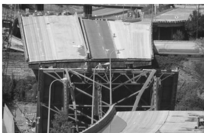
写真 2 上路トラス橋 の崩落事例
