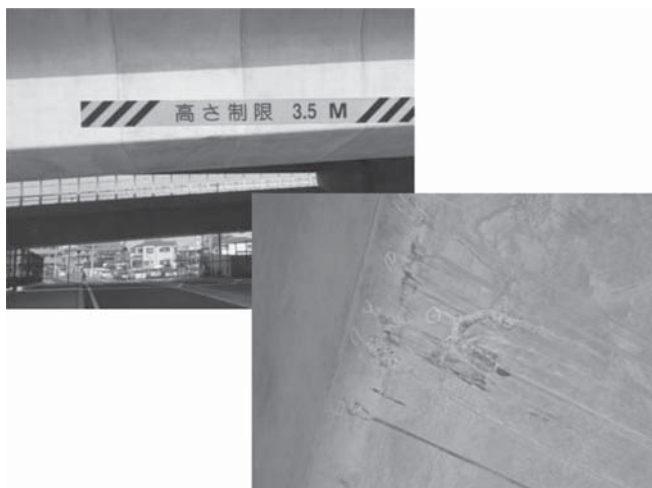
写真二 「ライブeカム」を活用した損傷箇所の現場映像
