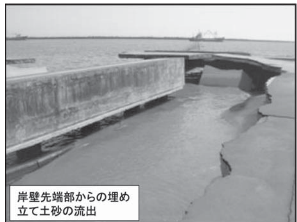
写真一2 岸壁の被災例（茨城港日立港区）
