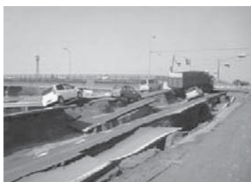
写真一 被災状況（江合川）
