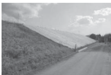
写真一六 小貝川（茨城県取手市）の被災状況と堤防切り返しによる復旧状況
