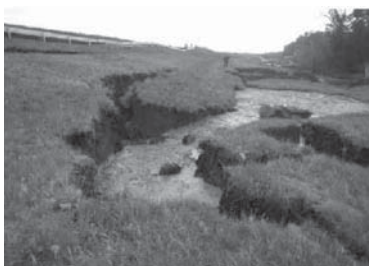
写真二 被災状況（江戸川）
