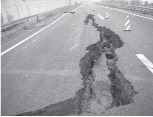
写真一 路面のひび割れ (東北道 福島飯坂IC～国見IC間)
