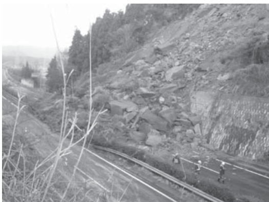
写真二 4月11日の余震による切土のり面の崩落 (常磐道 いわき勿来IC～いわき湯本IC間)
