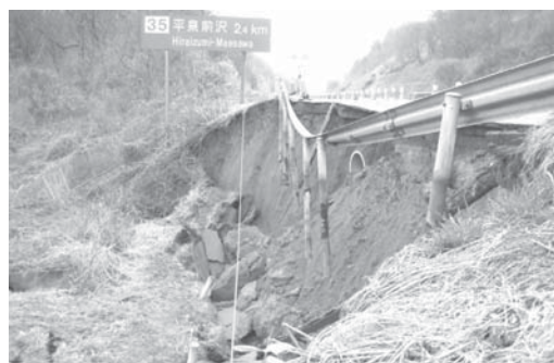
写真一10 被災の状況 (4月8日午前7時頃)
