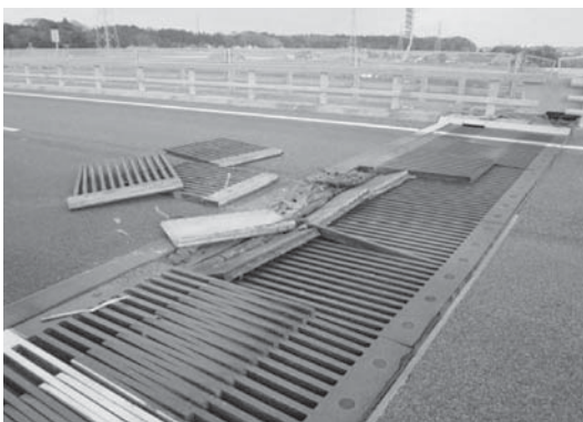
写真三 伸縮装置の破損 (東水戸道路 水戸大洗IC～ひたちなかIC間)
