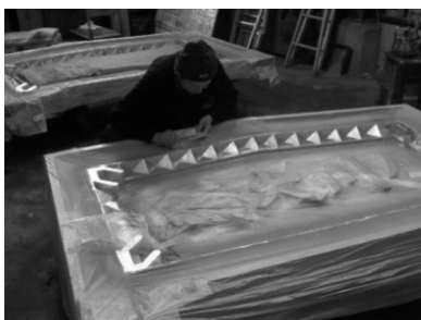
写真 6 橋名板への金箔貼り付け作業 高度な技術が必要なため、「鑄物の町」富山県高岡市の職人の手により作業が行われた
