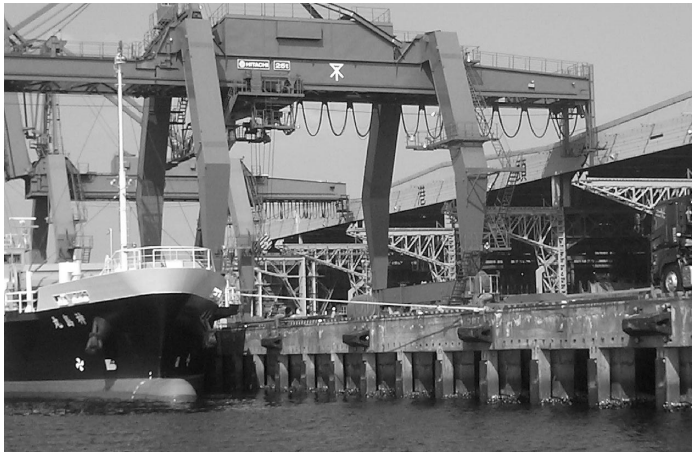
岸壁【コンクリート剥落】
