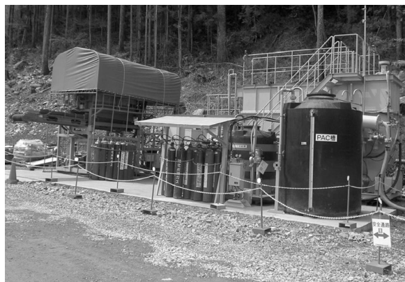
写真 1 濁水処理設備（機械処理脱水方式）
