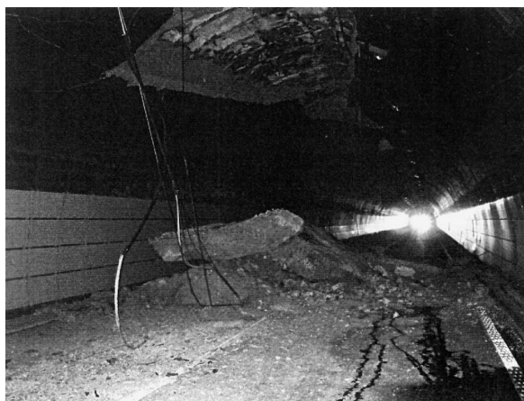
写真－1 コンクリートの剥落
