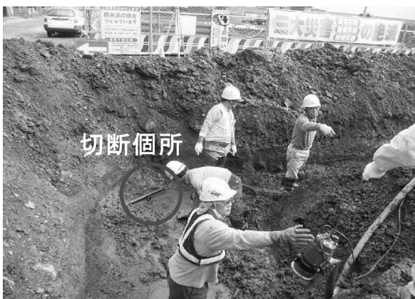
写真 2 バックホウによる埋設管損傷事故
