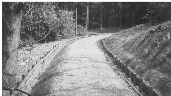
遠賀川（福岡県）における木製水路および土留工
