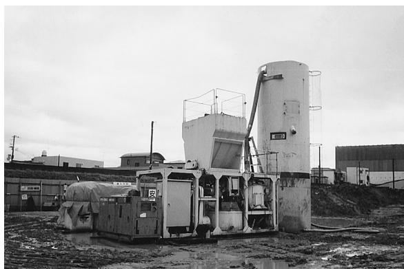
写真－４ プラント全景
