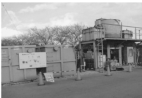
写真-5 排水汚泥処理
