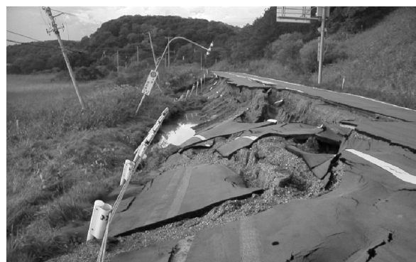
写真－12 地震により被災した道路 （北海道豊頃町 道道大津長節線）
