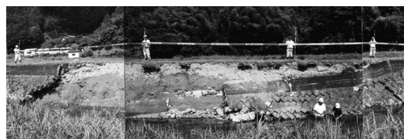
写真－4 台風第4号に伴う豪雨により被災した河川護岸 （高知県中村市 一級河川勝間川）
