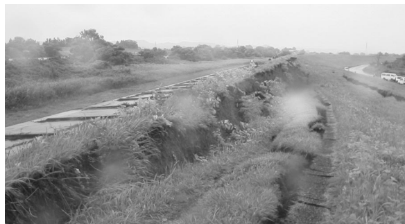
写真－7 地震により被災した河川堤防 （宮城県鹿島台町 一級河川鳴瀬川）
