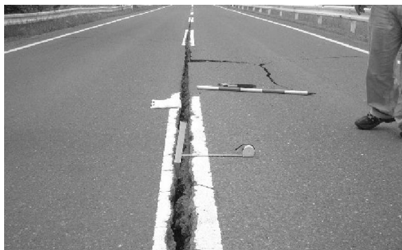
写真－2 地震により被災した道路 （宮城県加美町 主要地方道最上小野田線）
