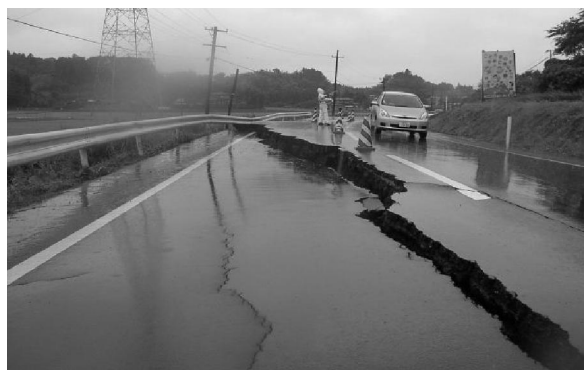
写真－8 地震により被災した道路 （宮城県矢本町 主要地方道石巻鹿島台大衡線）
