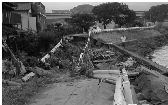
写真－5 梅雨前線豪雨により被災した河川護岸 （福岡県太宰府市 二級河川御笠川）
