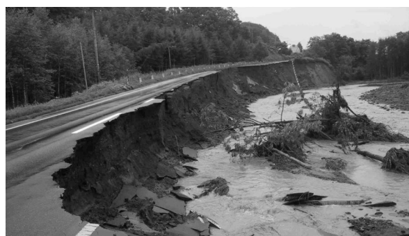
写真－10 台風第10号に伴う豪雨により被災した道路 （北海道新冠町 道道平取静内線）
