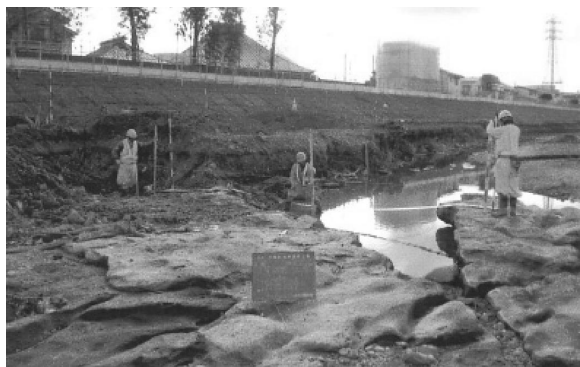
写真-1 想定していた地盤高より高い位置に河床（土丹層）が確認される
