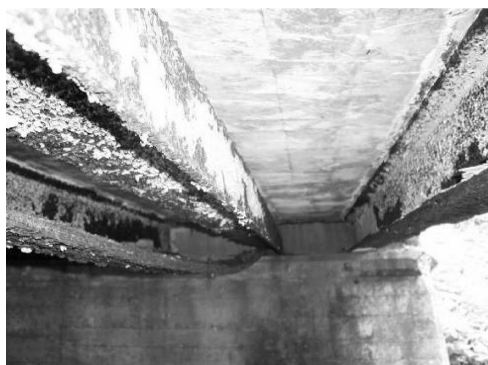
写真－2 損傷が発見された橋
