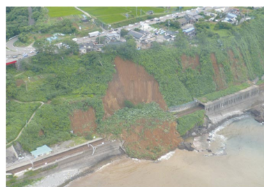
柏崎市青海川におけるがけ崩れ
