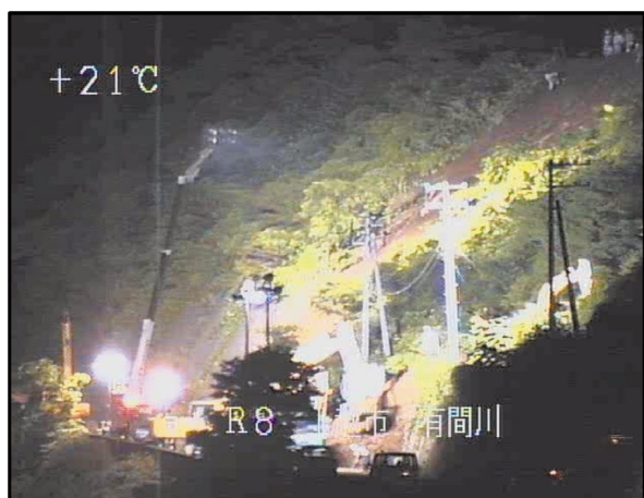
国道8号上越有間川 法面崩壊現場の照明車
