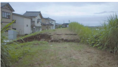
二級河川鯖石川 堤防被災状況
