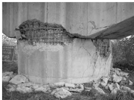
図 1 新潟県中越地震により被災した橋脚 (国道17号小千谷大橋)
