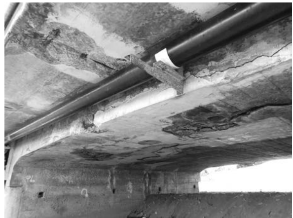
写真-3 塩害による旧橋の劣化状況
