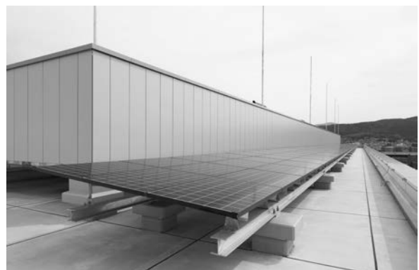
写真－9 太陽光発電設備
