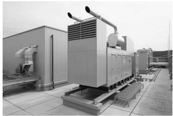
写真－6 自家用発電機
