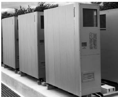
写真-2 水素燃料電池発電設備
