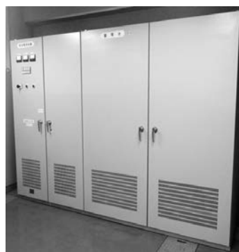
写真-1 直流電源装置
