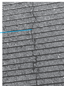
写真4 検知したひび割れの拡大図
