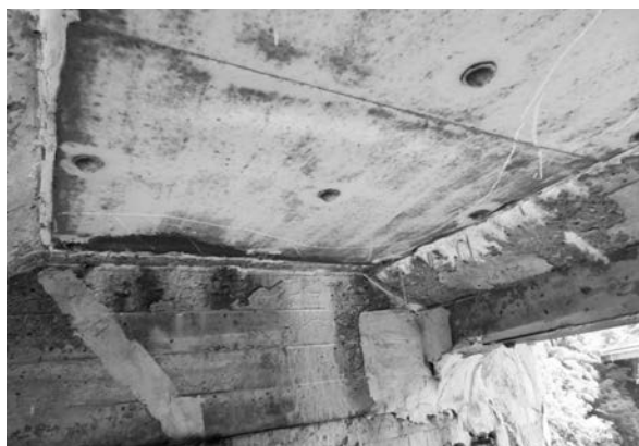
写真－4 腐食した補強鋼板
