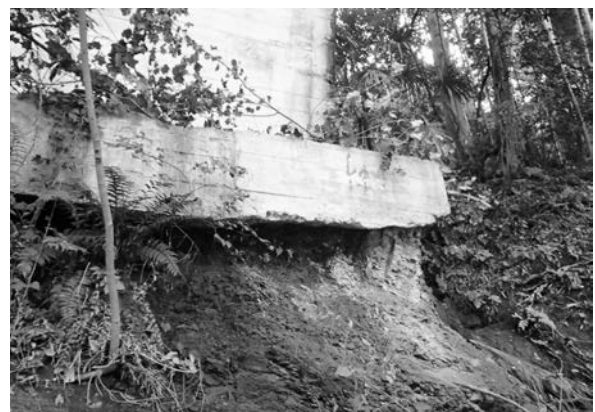
写真-2 P4アーチアバットの浸食
