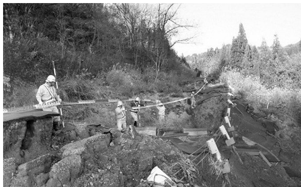
写真-3 道路路肩崩落
