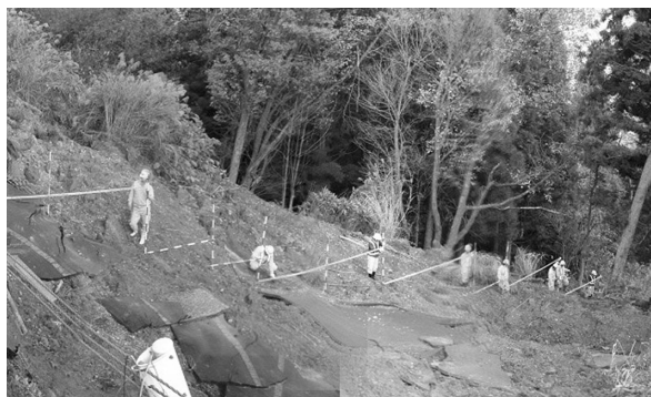
写真-2 道路崩落
