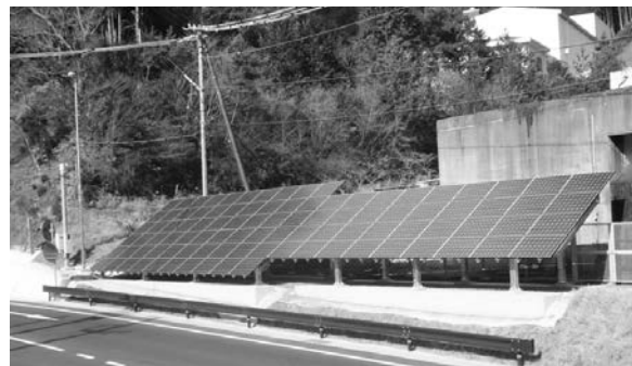
写真－2 太陽光発電設備
