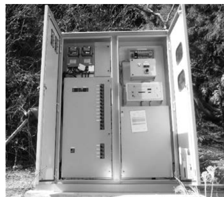
写真－3 自立型分電盤
