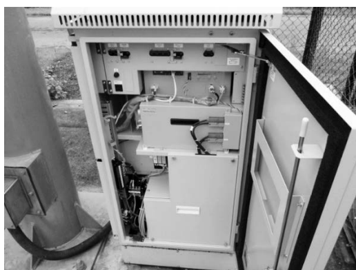
写真－４ 屋外用無停電電源装置
