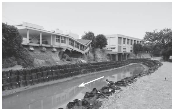
写真－3 桂川の流水により被災した比良松中学校（朝倉市宮野）
