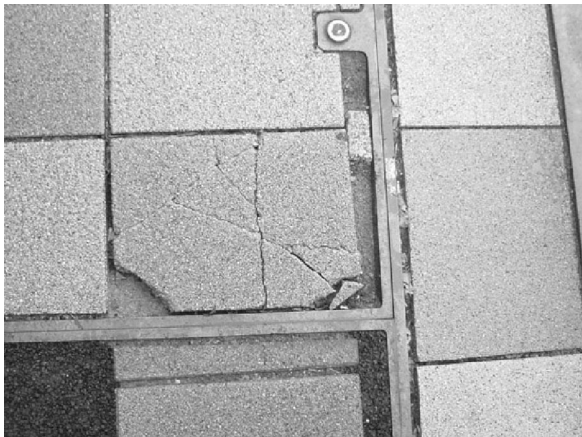
写真-3 ブロックの破損事例
