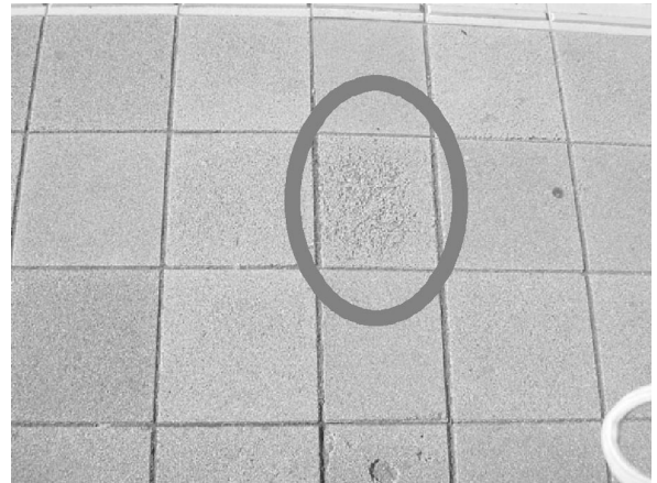
写真-4 表面があばた状になった事例
