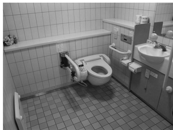
写真－3 簡易多機能トイレ1
