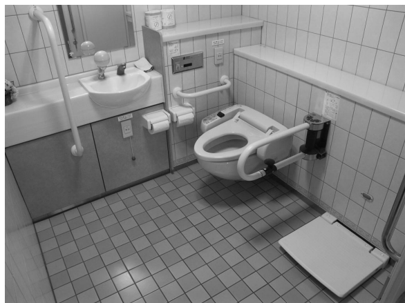
写真-4 簡易多機能トイレ2
