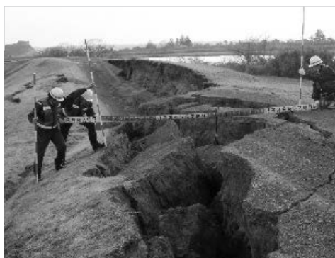
写真－5 河川堤防の被災調査
