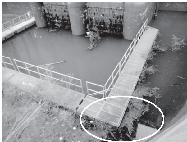
写真－3 令和元年10月実証実験 発電取水用除塵フロート 標高153.2m付近でフロート底面が岸接触
