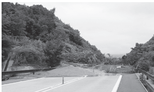
写真-4 【土砂崩落】東広島呉自動車道 高屋 JCT ~阿賀 IC
