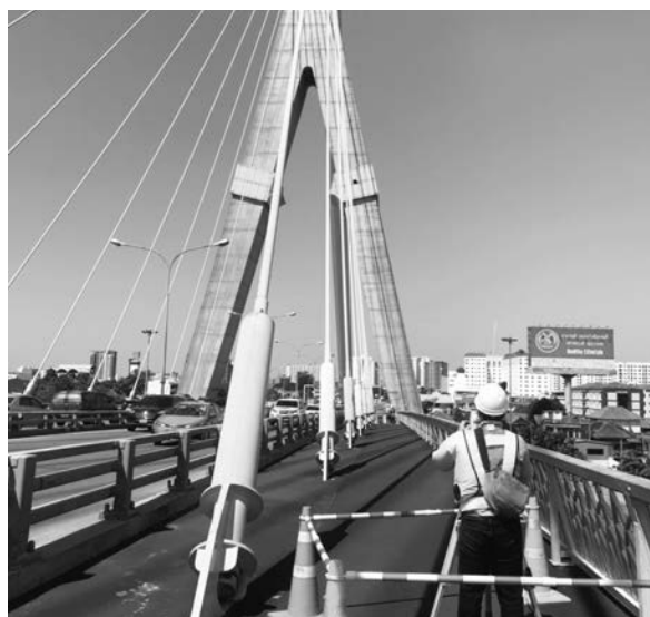
写真-3 ラマⅧ世橋ひび割れ計測業務
