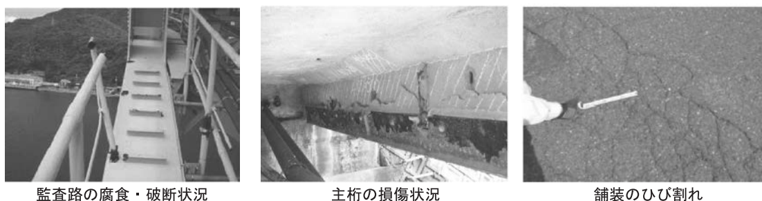
図－1 インフラ老朽化の状況（橋梁）
