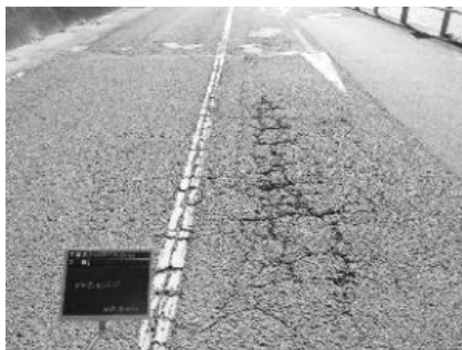
写真－1 舗装面のクラック
