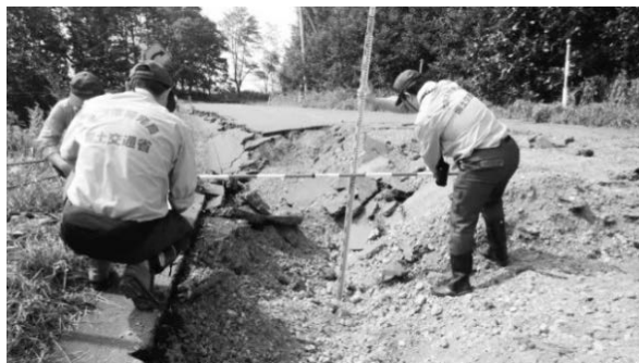
写真－16 被災状況調査（北海道安平町）
