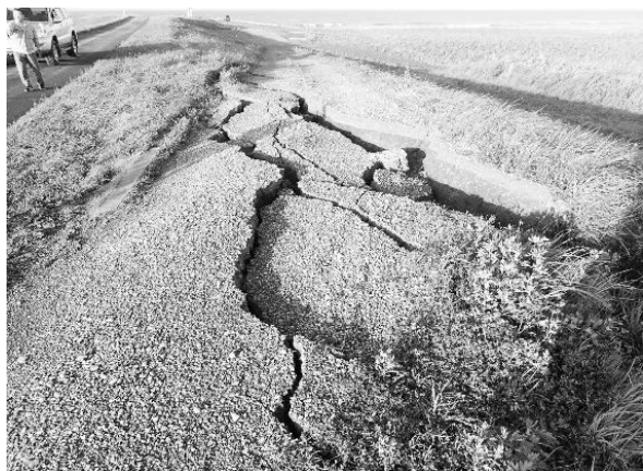
写真－4 鵠川における堤防縦断亀裂 (むかわ町)
