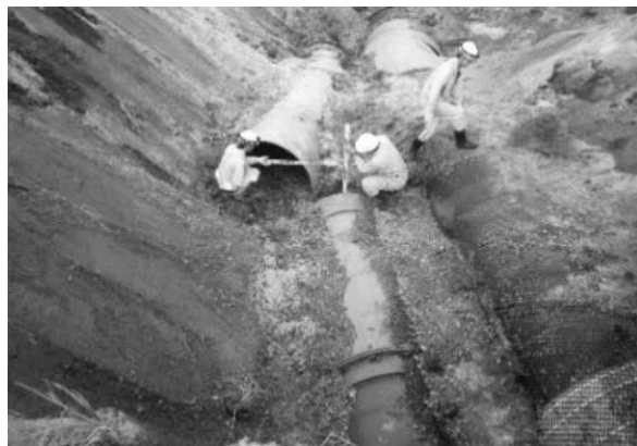
写真－5 管水路の離脱 (勇払東部地区)
