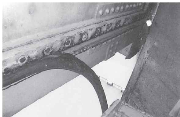
写真－5 水密ゴム破損状況（平成 26 年度）
