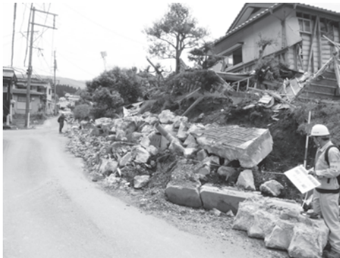
写真－２ 宅地擁壁の被害（熊本地震）
