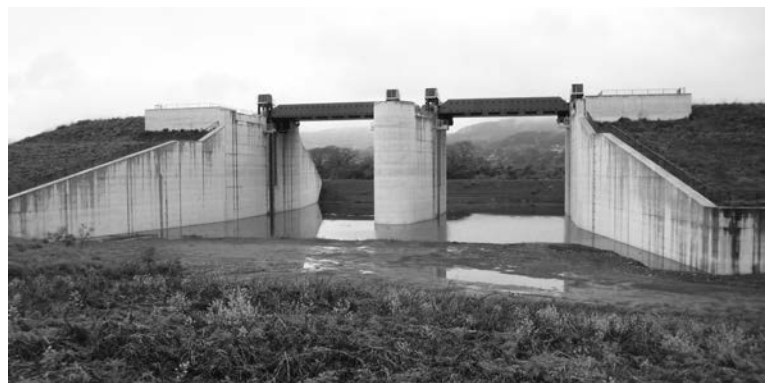
写真-1 大林水門ゲート設備の全景（堤内側から）
