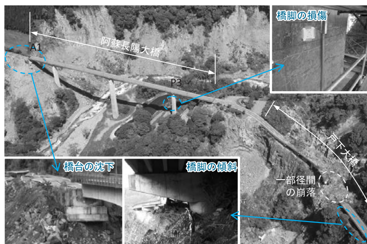
写真-1 長陽大橋ルートの代表的な損傷
