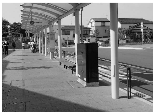
写真－8 バス停上屋やベンチ等と合わせて地上機器を設置している事例
