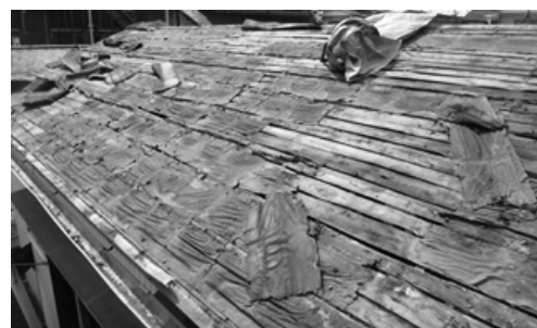
写真-2 屋根にアスファルトフェルト 8 kg/巻品を使用して劣化した事例
