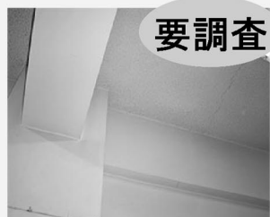
アスベスト含有吹付けひる石
