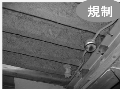
吹付けアスベスト
