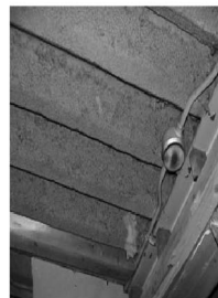
吹付けアスベスト
