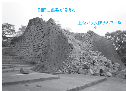
写真－2 石垣の崩落（二の丸御門跡）
