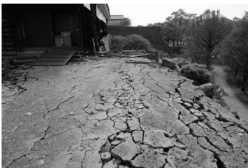
写真－5 地割れ（数寄屋丸）
