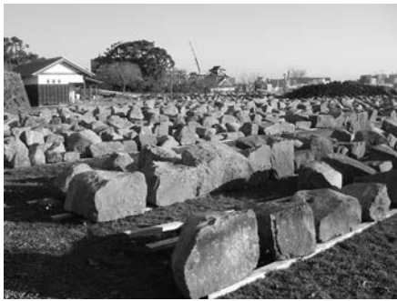
写真－8 石垣復旧の準備（崩落した築石）
