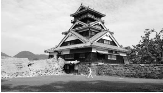
写真－3 重要文化財建造物の被害（宇土櫓）
