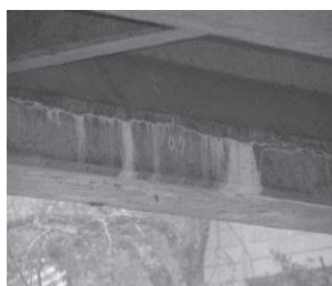
(PCケーブル部の漏水)
