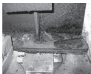
(桁端部の腐食)
