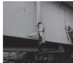
(排水管の破損)
