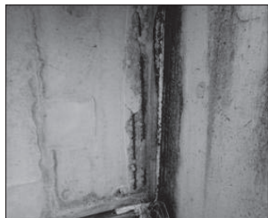
(桁端部の鉄筋露出)
