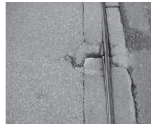
(伸縮部の損傷)
