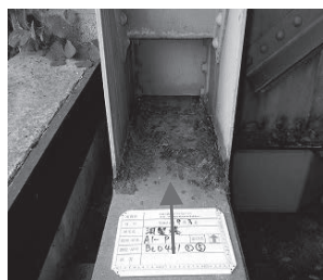
(トラス構造の腐食)
