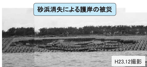
写真一 3 護岸被災状況
