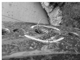
写真—5 ネジ山切断
