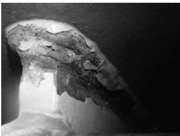
写真一 1 損傷事例
